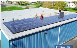
Elmira, NY 15kW
